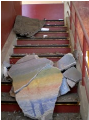
Daños ocasionados en el mural por el sismo de 8.8 en la escala Richter, ocurrido el 27 de febrero de 2010.
