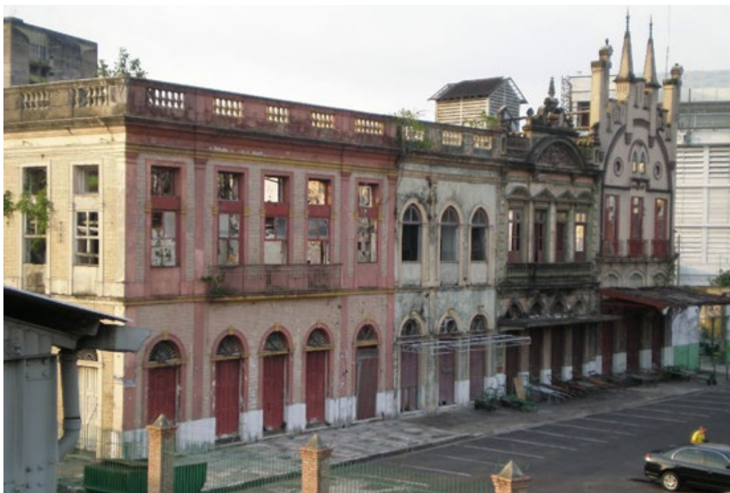
Figura 1. Conjuntos urbanos deteriorados por la falta de acciones de conservación y no afectación de recursos.
